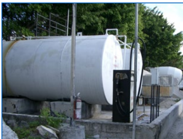
AST de una pared y dispensador dentro de contención secundaria
