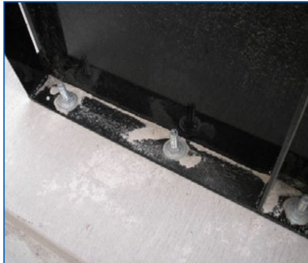
Verifique la base del tanque y que este anclado
