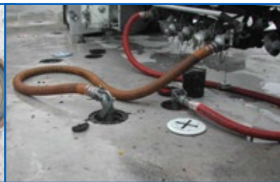
Suministro de combustible con el sistema de recuperación de vapores fase I activado
