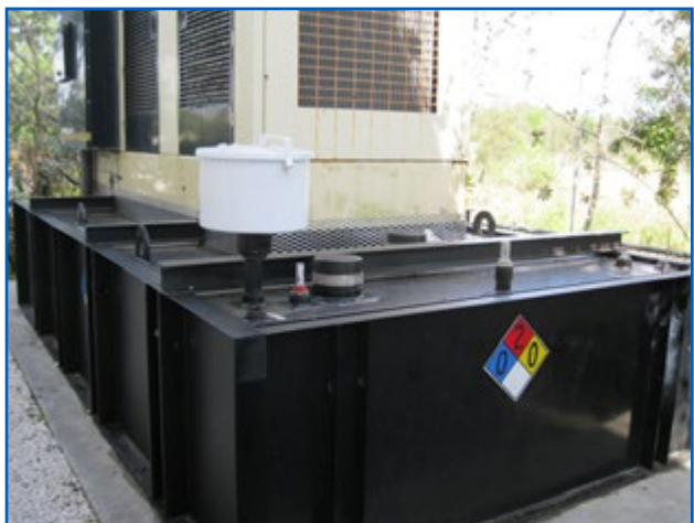
Generador eléctrico de emergencia con tanque AST de pared doble
