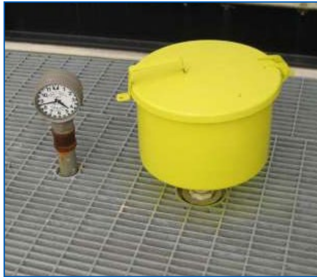
Reloj medidor de sobrellenado
