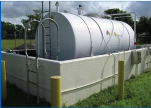
AST de acero de pared simple en contención secundaria de concreto
