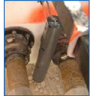
Sensor de boya en la caja del dispensador
