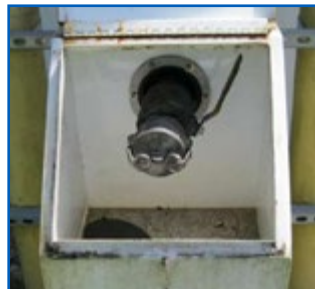
Tapas de la tubería de abastecimiento
