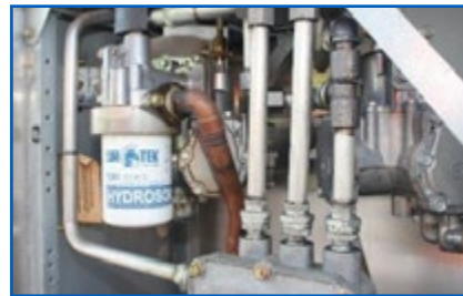
Filtro de combustible instalado en su lugar
