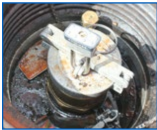
Tubería de abastecimiento con tapa
