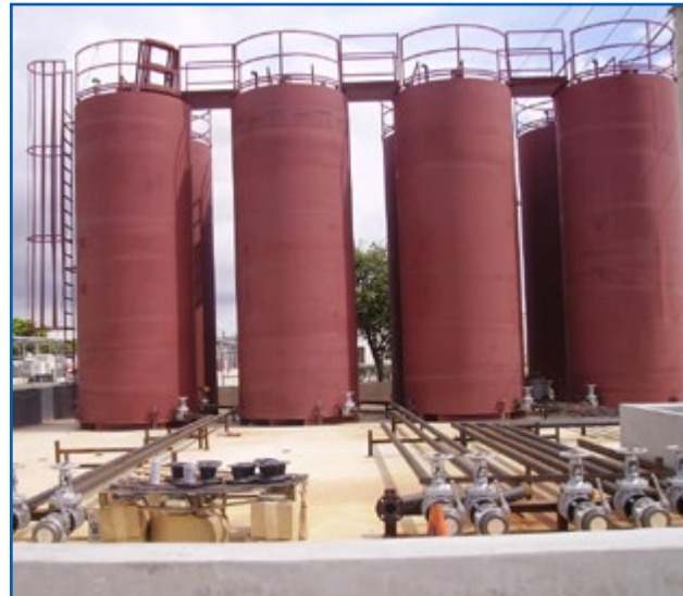
Verifique dimensiones de contención secundaria
