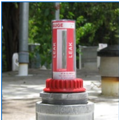
Detección de fuga
