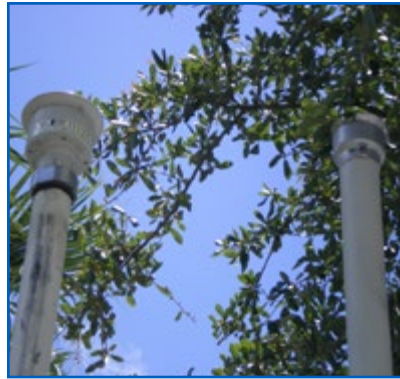
Tubería de ventilación con válvula
