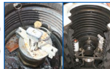
Válvula de drenaje en el balde de derrame Vista de recorte del balde de derrame
