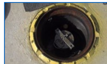
Tapa sobre tubería de abastecimiento
