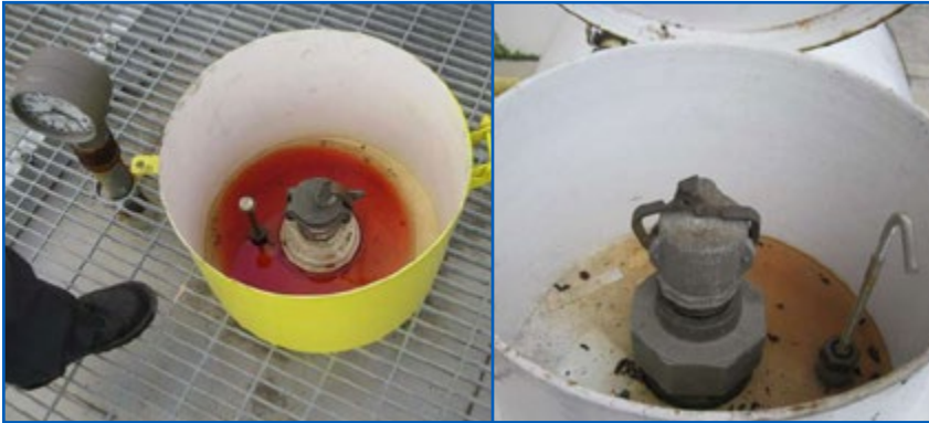
Cubo de derrame con válvula de drenaje
