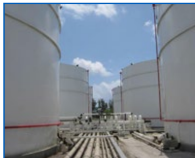
Tubería para AST erigidos en el campo
