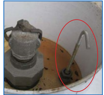
Válvula de drenaje
