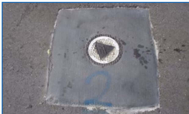
Pozo de observación
