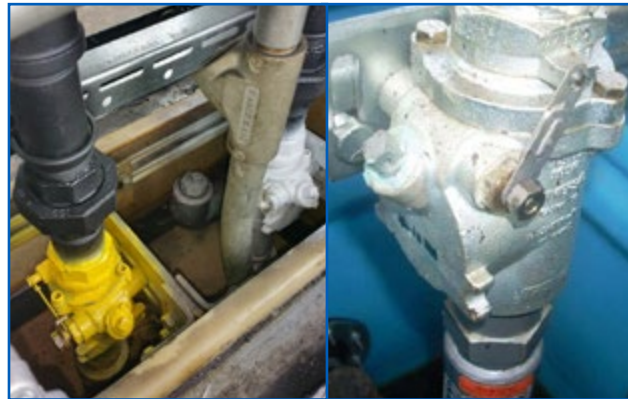
Válvula de corte de emergencia asegurado a su soporte
