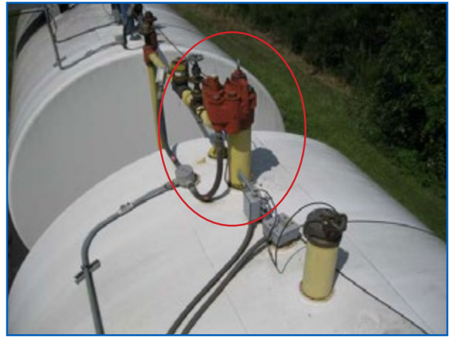
AST con bomba de turbina sumergible arriba del tanque
