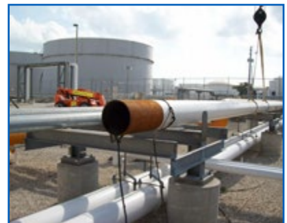
Tubería para AST
