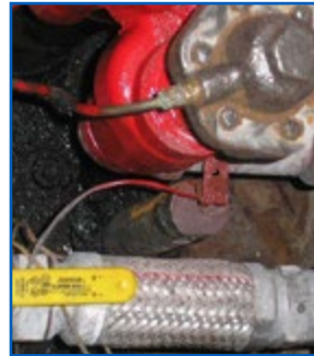
Sensor de boya en el sumidero de la bomba
