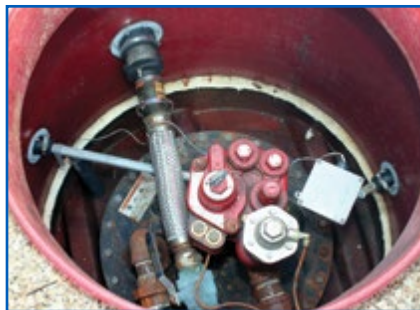
Tubería, bomba y detector de fugas de tubería dentro del sumidero
