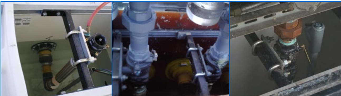
Válvula de corte de emergencia a la altura correcta. Note la válvula anclada al dispensador
