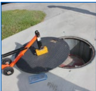
Cobertura para el sumidero de la bomba sumergible
