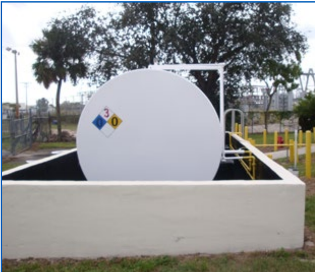
Verifique cobertura del tanque e integridad del contenedor
