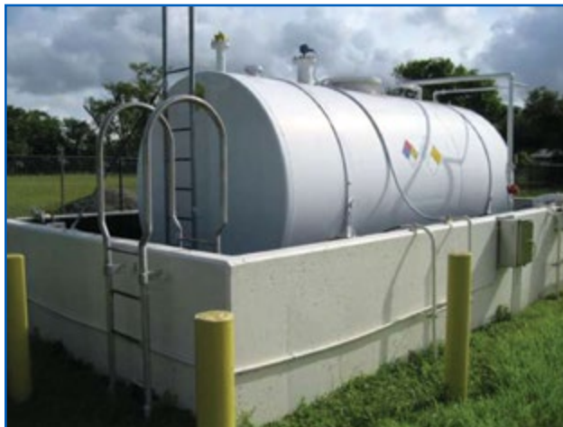
AST dentro de contención de concreto
