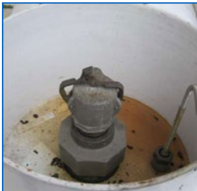
Cubo de derrame encima del tanque
