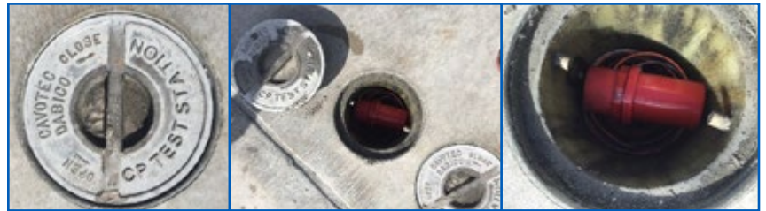
Estación de prueba de protección catódica
